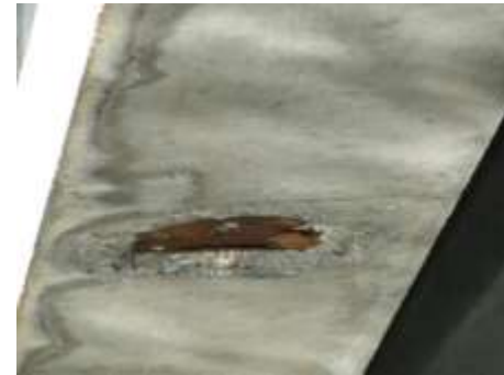
コンクリート桁の剥離・鉄筋露出
