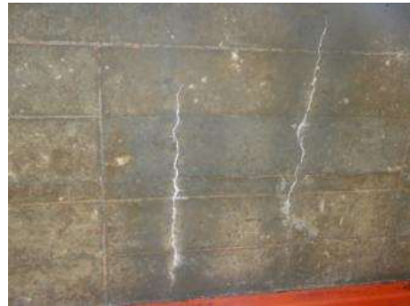
コンクリート床版のひびわれ・遊離石灰
